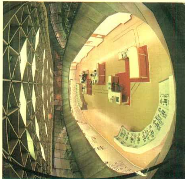
Sala de controle da usina de Itaipu
