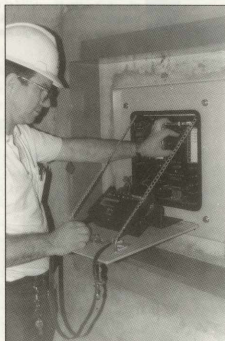
Através desta "caixa preta" é possível fazer a auscultação de 632 instrumentos elétricos espalhados por todo o concreto da barragem.
