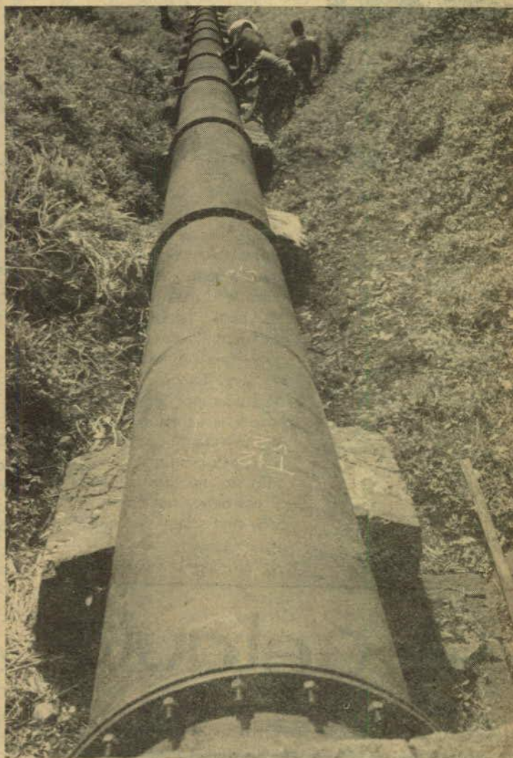
Conduto forçado: 90 metros de queda
