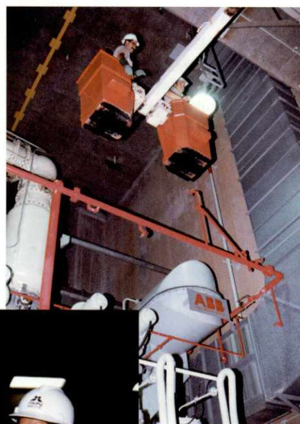
Na galeria dos transformadores: acesso às lâmpadas com o hidrabasket.
