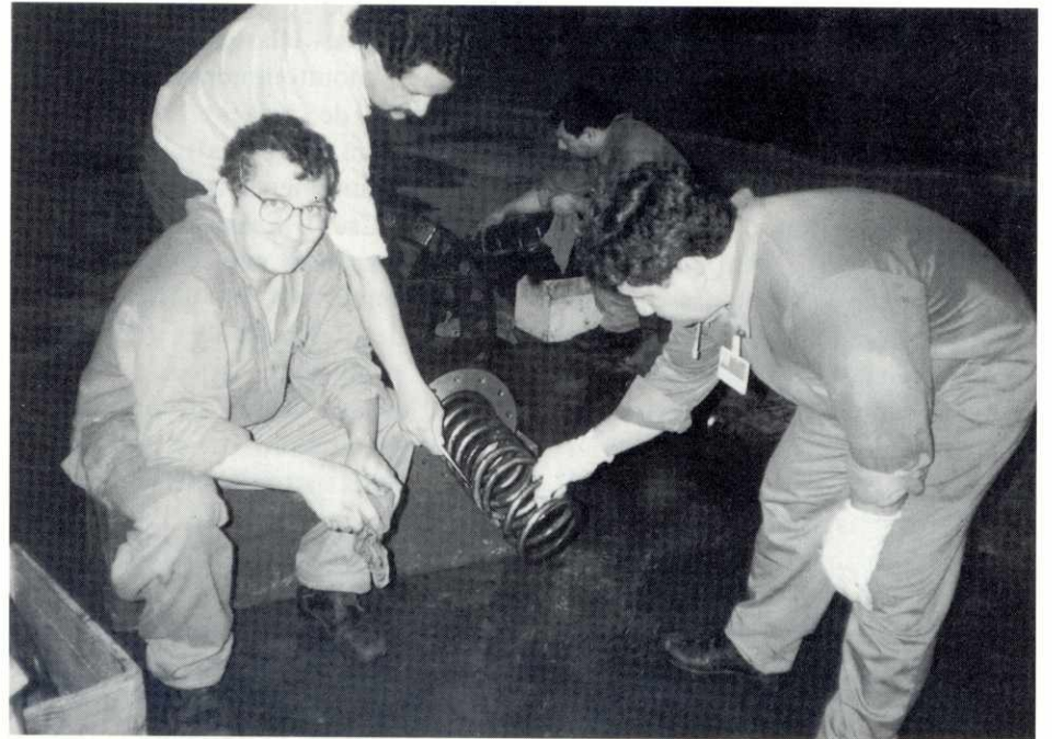
Quebra desta mola provocou o defeito na unidade geradora 5.
