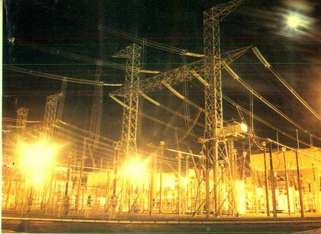
Panorâmica noturna da central de Furnas, Foz do Iguaçu
