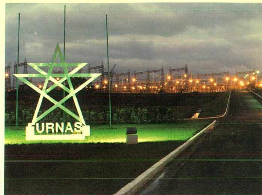
Subestação de Furnas
