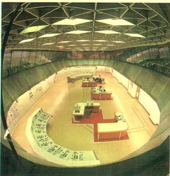
Sala de controle da usina de Itaipu
