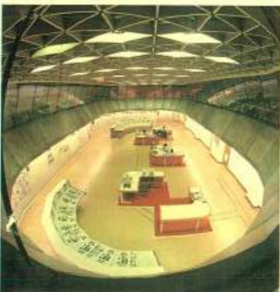
Sala de controle da usina de Itaipu
